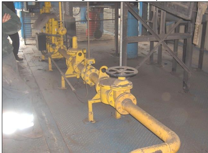
Foto 9 Gasleiding die de droogtrommel voor gerecycled materiaal voedt
