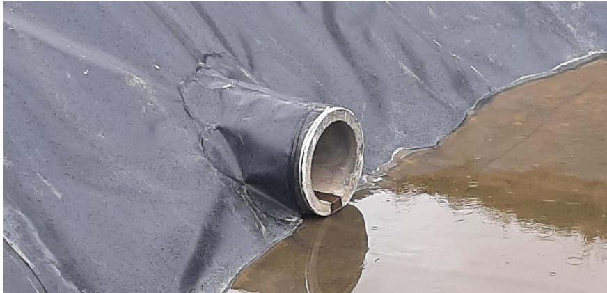
Foto 5 Hemelwater dat het bufferbekken binnenkomt
